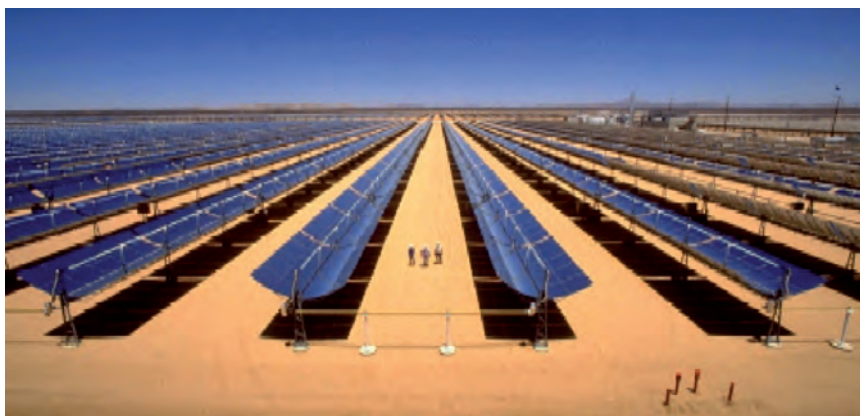
Figura 9. Aspecto del campo solar de las plantas SECS situadas en Kramer Junction, California.
